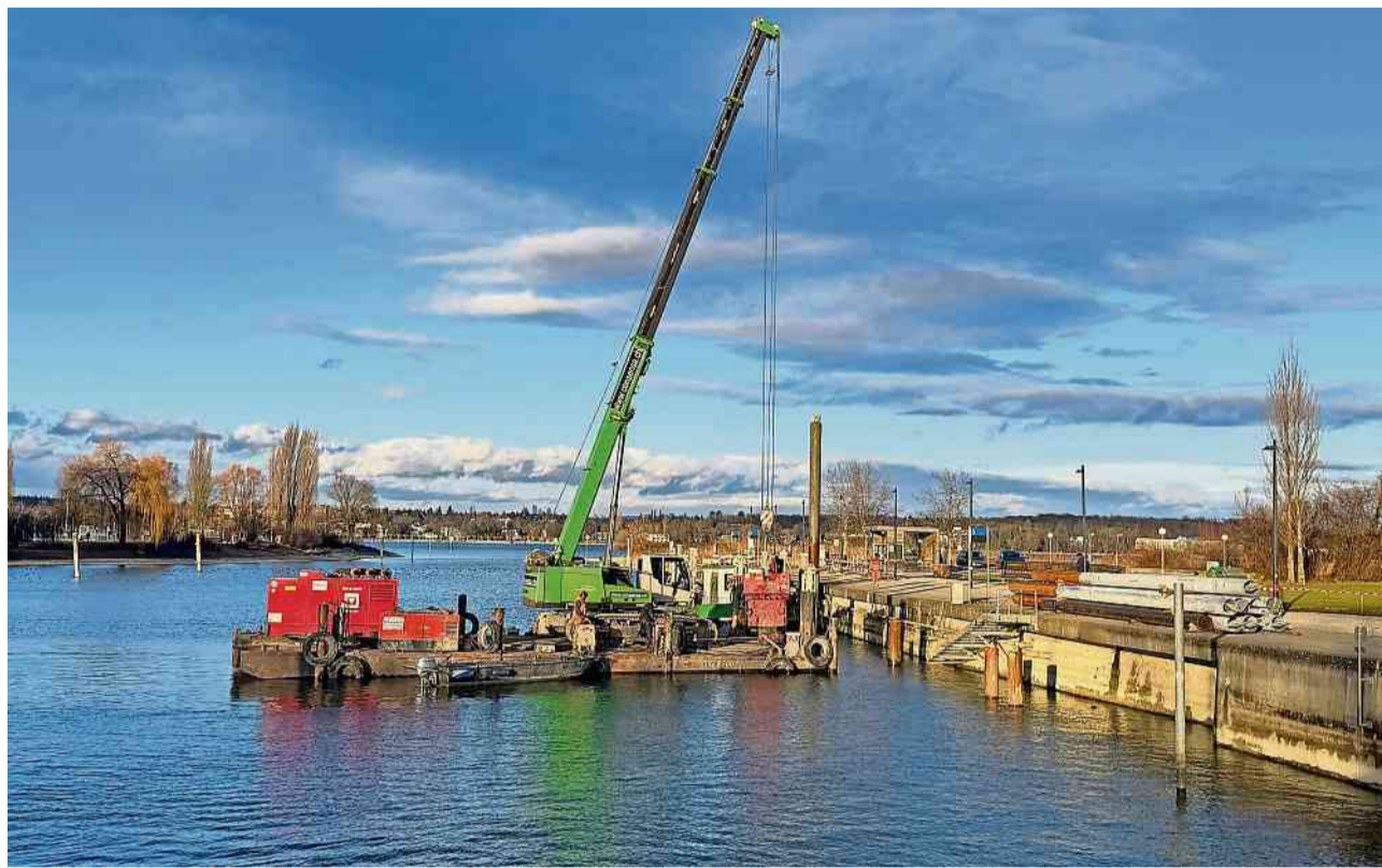
Bauarbeiten auf dem Wasser: neue Dalben für die Steganlage werden in das Hafenbecken gerammt.
